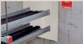
Cable tray, cables, conduits
