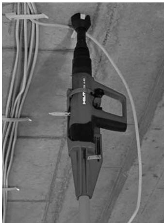
Fixation de câbles et de conduits
